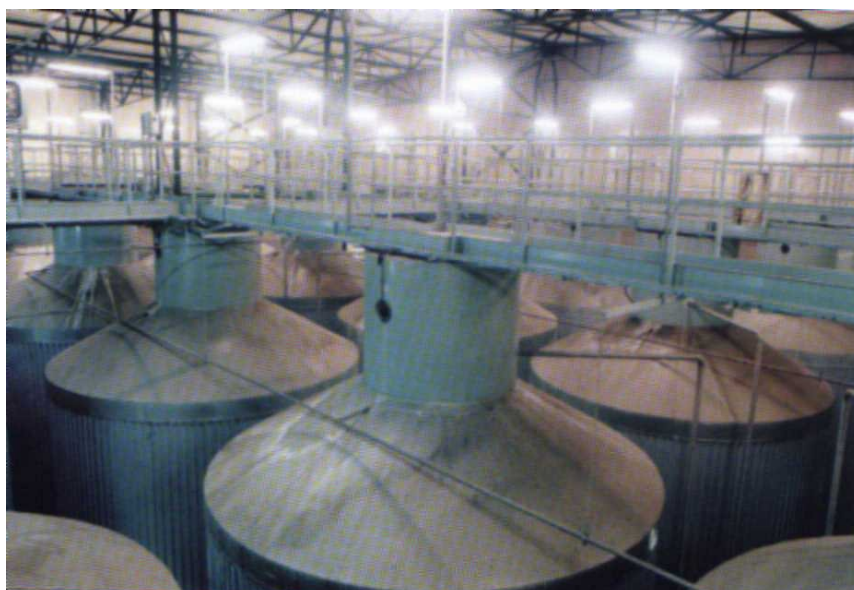
Obr. 11 - Instalace tanků v budově v pivovaru Prazdroj (Plzeňský Prazdroj a.s. Plzeň).
